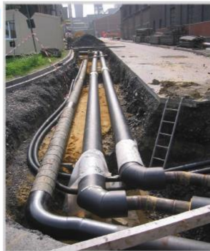
Fernwärmeleitungen eines Wärmenetzes
