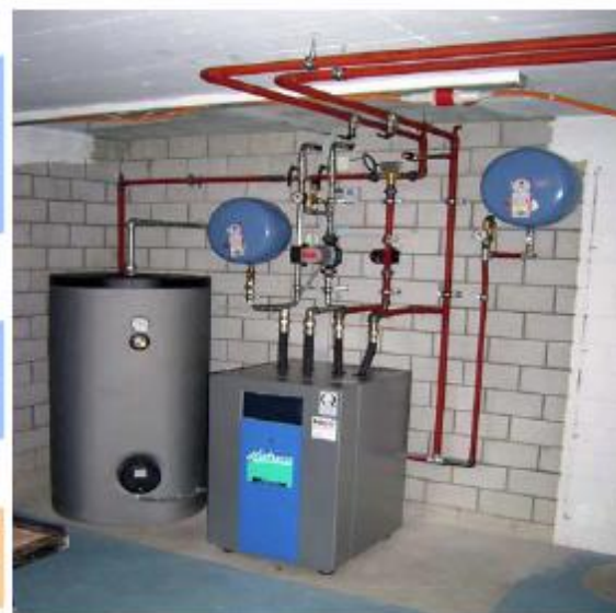
Wärmepumpe mit Wärmeverteilung
